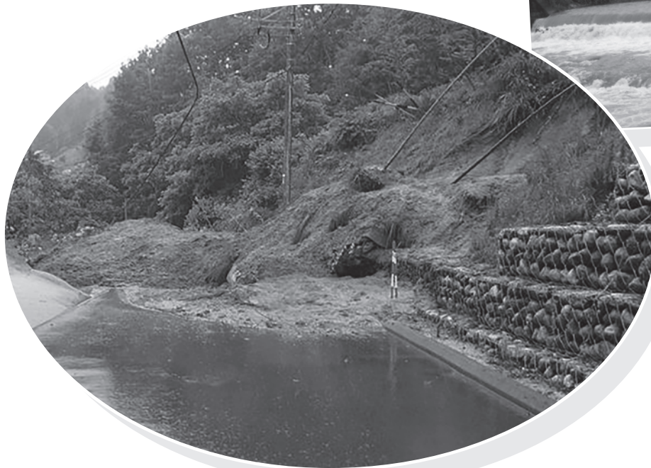
土砂崩れで通行できなくなった市道千代15号線(千代 法全寺)
